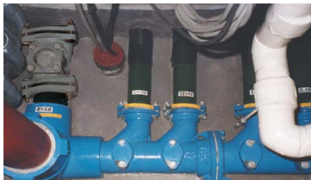
▲排水ヘッダ 設置例 (PS内設置)
